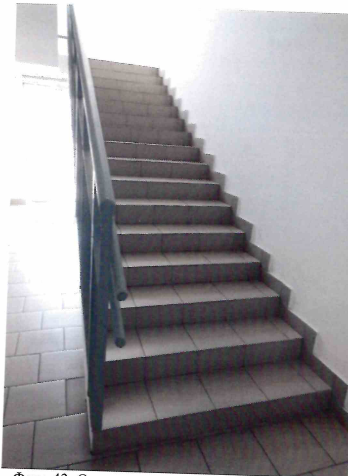
Фото 43. Отсутствие ограждения под маршем открытой лестницы
