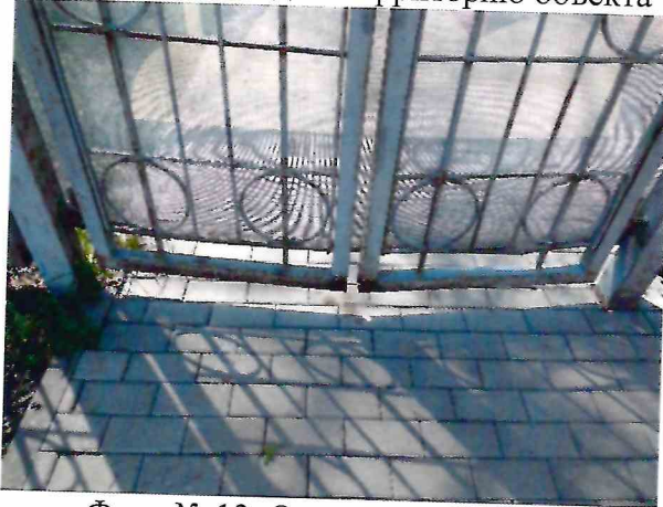
Фото № 13. Отсутствие порогов
