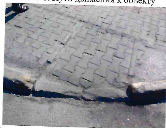
Фото 10. Ненормативный бордюрный съезд
